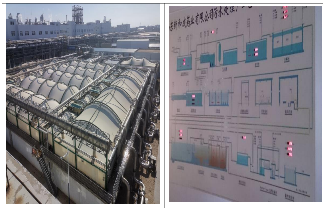
图 4.1-5 污水站及 PLC 控制系统
